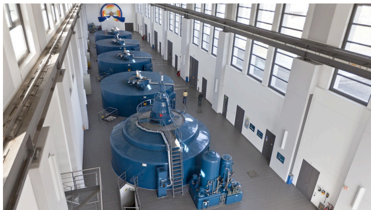
Abbildung 11.1: Die Generatorhalle im Fließkraftwerk Gösgen (SO).
